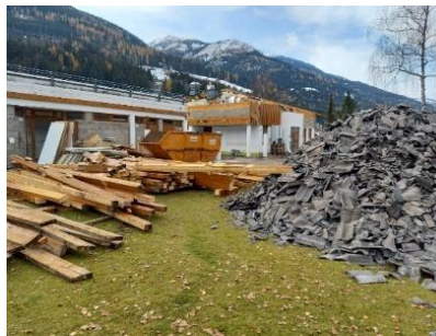
Das alte Gebäude wird abgerissen und ein neues an gleicher Stelle errichtet.
